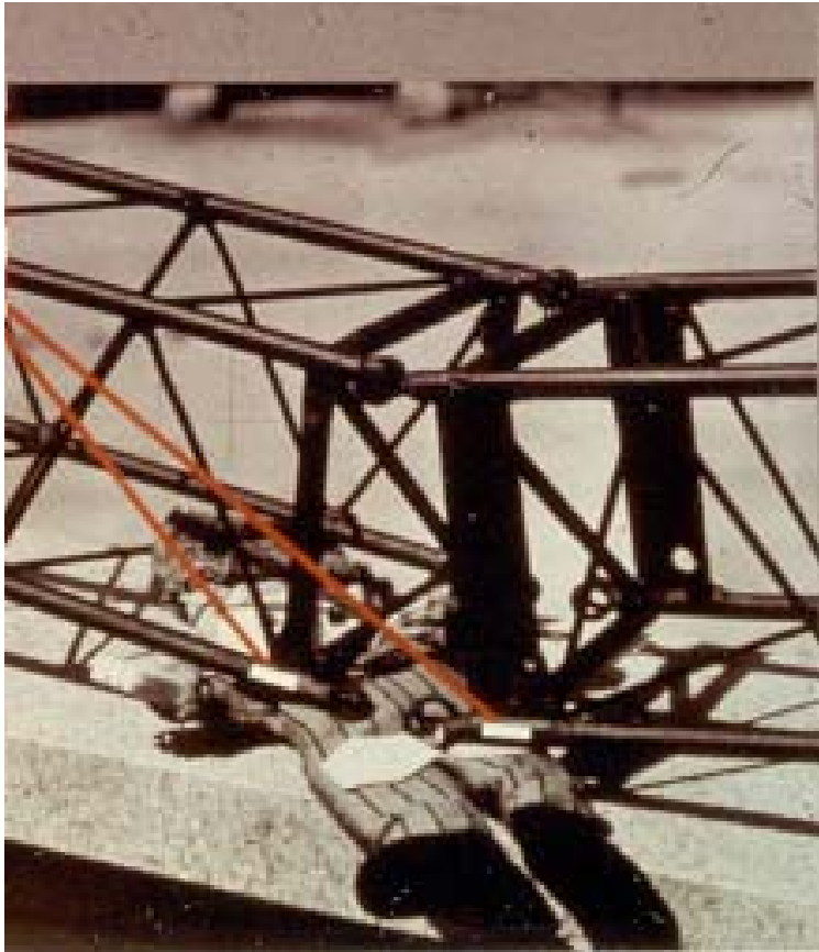
Persona atrapada debajo del armazón de la pluma de una grúa durante su desmantelamiento
